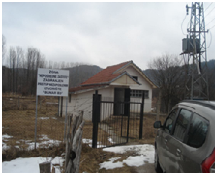
Сл.8. Пумпно Постојење на бунару „Б3“ у алувијону реке Драговиштице
