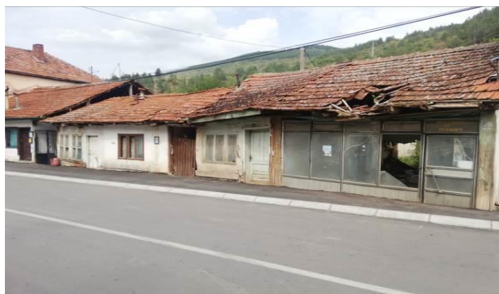
Текстилна продавница ул. Краља Петра Првог Карађорђевића бр. 24 и 22 на к.п. бр. 506 КО Трговиште, док је радња на броју 20 на к.п. бр. 508 КО Трговиште срушена.
